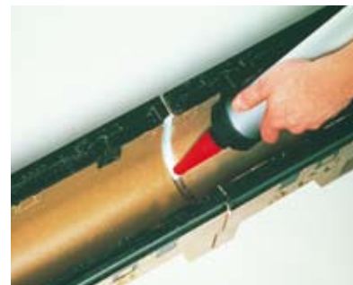
9. Wypełnianie bezpiecznej fugi masą uszczelniającą systemu ACO w celu zapewnienia wodoszczelności kanału.
