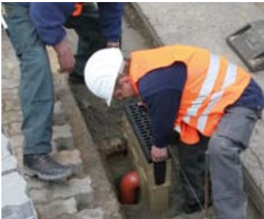
4. Wstawienie i podłączenie skrzynki odpływowej do kanalizacji deszczowej. Podłączenie króćca do skrzynki odpływowej.
